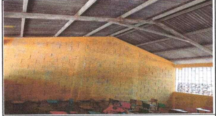
Foto 4: Se puede observar el deterioro de la estructura portante, desprendimiento de la pintura en las paredes en el modulo 1
