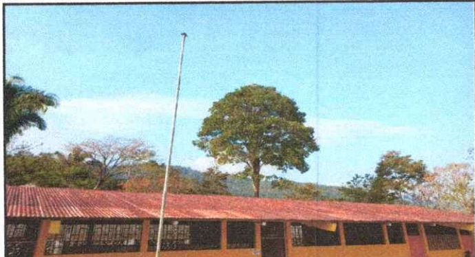
Foto 1: Se puede observar el deterioro de las laminas portantes del modulo 1.
