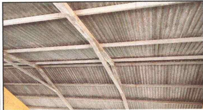
Foto 2: Se puede observar el de deterioro de las estructuras portante del modulo 1
